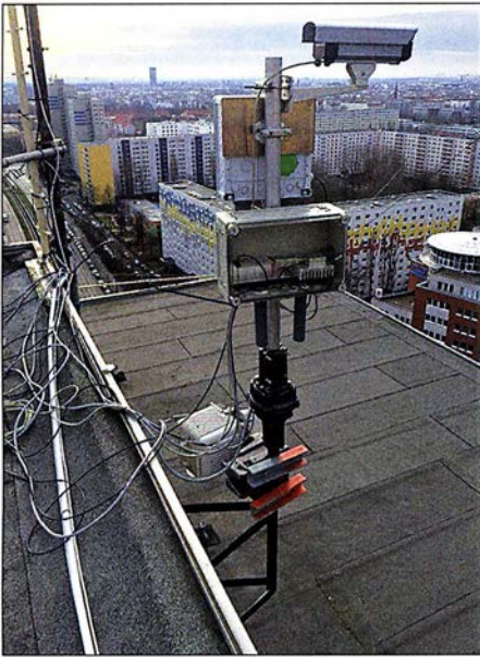
Die Outdoor-Unit von DB0KK: im Vordergrund die 24-GHz-Bake, darüber die 47-GHz-Bake und eine LAN-Kamera (damit DC7YS weiß, in welche Richtung die Bake steht); am Mastfuß ist der Rotor zu sehen.
